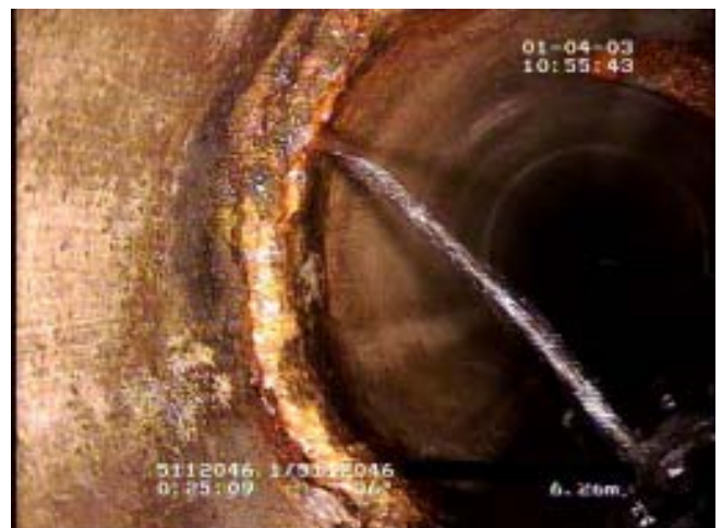
Undichte Rohrverbindung mit Wassereinbruch
